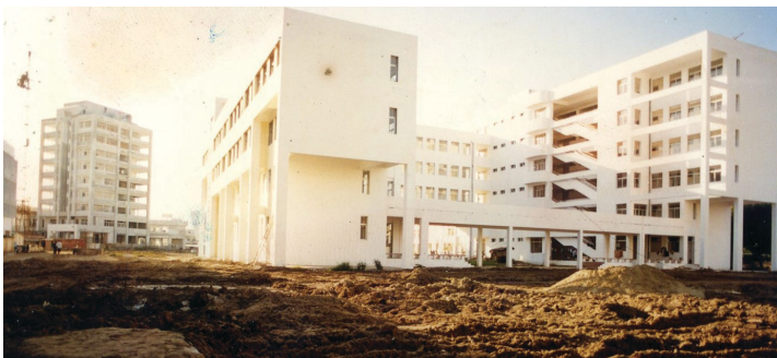
Xây dựng cơ sở hạ tầng của ĐHQGHN tại khu vực Xuân Thủy, Cầu Giấy, Hà Nội, giai đoạn 1995 - 1998.
